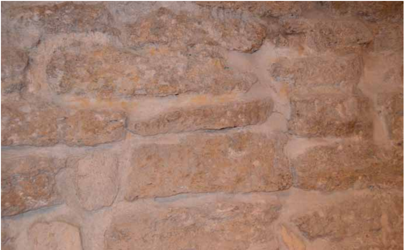
Ryc. 3. Lublin-Wzgórze Zamkowe. Układ kamieni w licu cylindrycznej wieży widocznym od wnętrza pierwszego piętra południowego skrzydła budynku Muzeum Lubelskiego. Fot. A. Rozwałka
