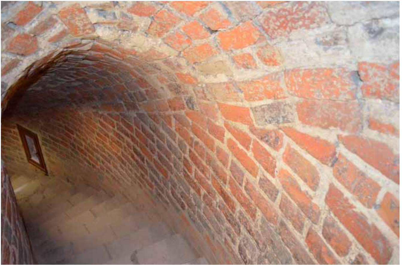
Ryc. 5. Lublin-Wzgórze Zamkowe. Fragmenty klatki schodowej cylindrycznej wieży. Fot. A. Rozwałka Abb. 5. Lublin-Schlossberg. Fragmente des Treppenhauses im zylindrischen Turm. Fot. A. Rozwałka
